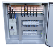
Armarios de concentración AC
